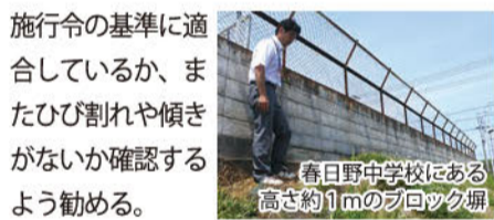
施行令の基準に適合しているか、またひび割れや傾きがないか確認するよう勧める。そして住宅の塀について危険度が大きいと市から判定された場合、一定の要件を満たせば、塀の除去工事費用の一部に対する市の補助金制度を利用することができる。同課には地震発生から25日までに24件の問い合わせがあり、職員が現場の調査にあっている。制度の詳細は市のHPまたは市建築指導課☎21-9732まで。
