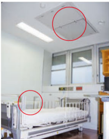
高い空気清浄機能をもつ「HEPAフィルター」を天井と壁に設置。空気を循環させ、室内を清潔に保つ
