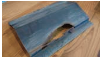
ドローン撮影した棟部分。朽ちて崩れつつある(上)錆びて剥がれた屋根材。こうなると落下の危険も(下)
